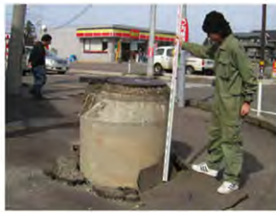
マンホールの浮上り
